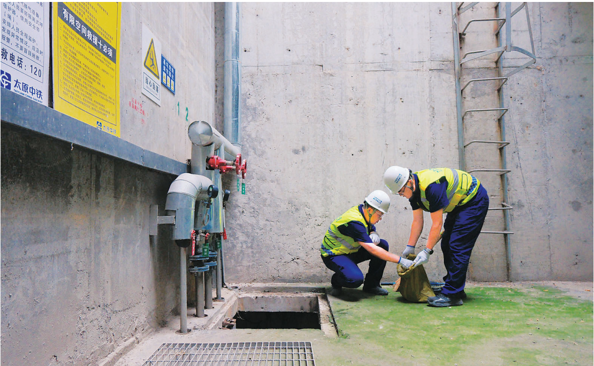
8月27日，中铁电气化局投资运营太原中铁公司运维人员对西桥地铁车站排水管路、阀门设施开展专项防汛巡检。工作人员逐一检查管路通畅状态，测试阀门启闭灵活性与密封严密性，保障排水设施的正常运行。 王韵菲 摄
