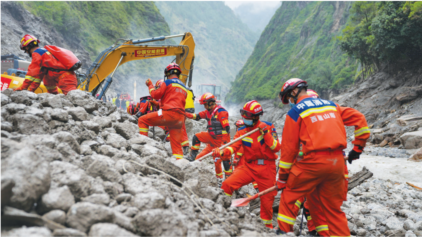
八月二十九日，消防救援人员在搜寻失联人员。 新华社记者 晋美多吉 摄
