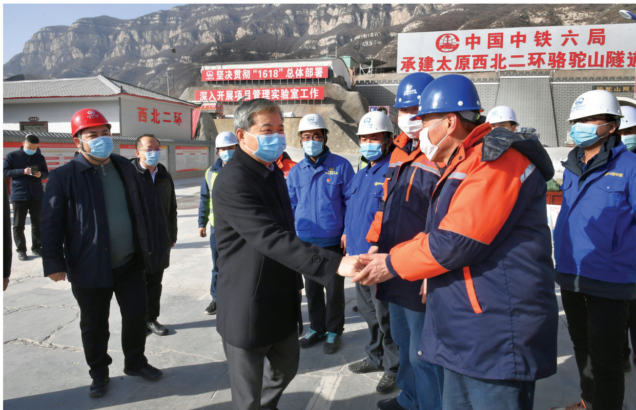
图为省委常委、市委书记罗清宇在太原西北二环高速公路骆驼山隧道施工现场看望慰问一线建设者。梁琛 摄
