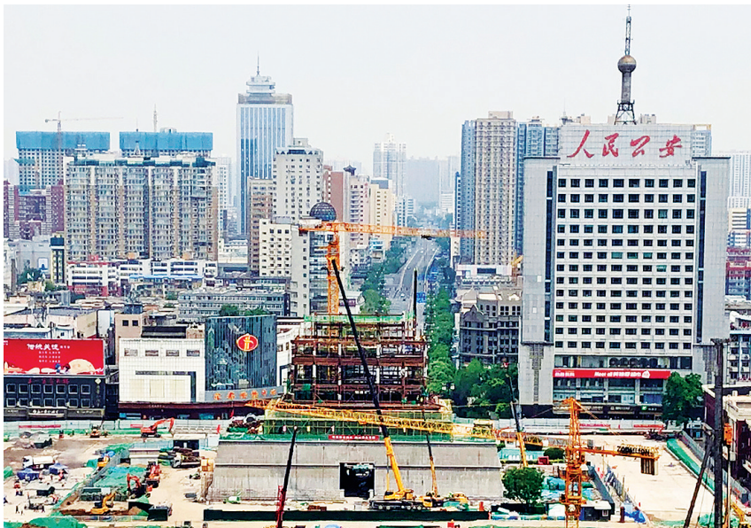
5月19日,五一广场改造工程现场,首义门初显雄姿。复建的首义门为仿古建筑,占地面积约1800平方米。目前,两层承台已完成主体结构施工,正在进行木结构城楼建设。 柴杰梁 邓寅明 摄
