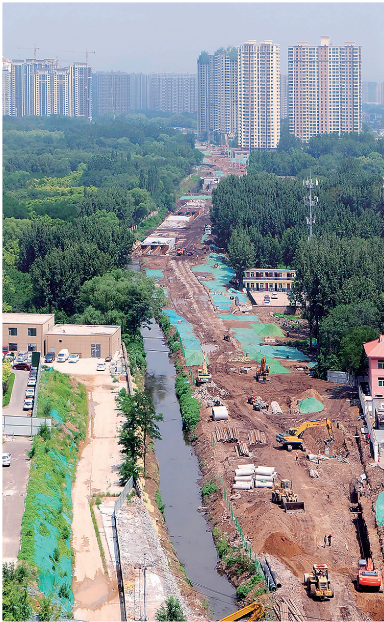
8月5日,我市森园路道排工程正在加紧施工。该工程位于森林公园东侧,北起尖草坪北街,南至北中环街,全长约3公里。 赵世凯 摄
