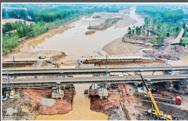
10月13日拍摄的南同蒲铁路昌源河大桥抢险现场。
