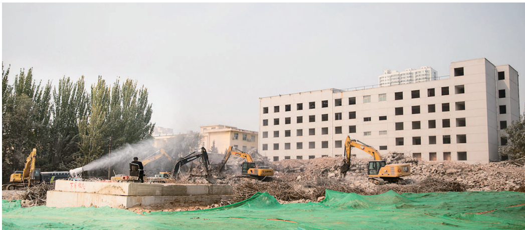
10月26日,位于朝阳街的山西省档案馆旧馆正在拆除,为地铁1号线朝阳街站的建设腾出空间。 王韵菲 孙卓阳 摄
