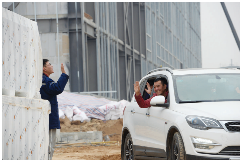
春节临近,1月17日,市集中供热阳曲热源项目工地,务工人员陆续完成施工任务,踏上返乡路。 牛利敏 宋卫东 摄
