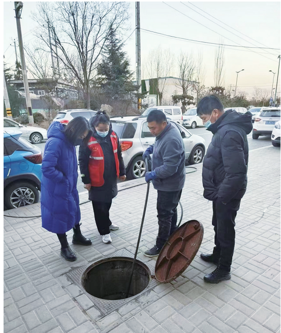
1月31日,盛西街枣盛苑小区整修路面施工中,有几块大石头掉进下水井里,导致管道断裂。枣尖梁社区为了不影响居民正常生活,立即联系维修人员进行修理,很快将管道修好。 韩睿 武晨 摄
