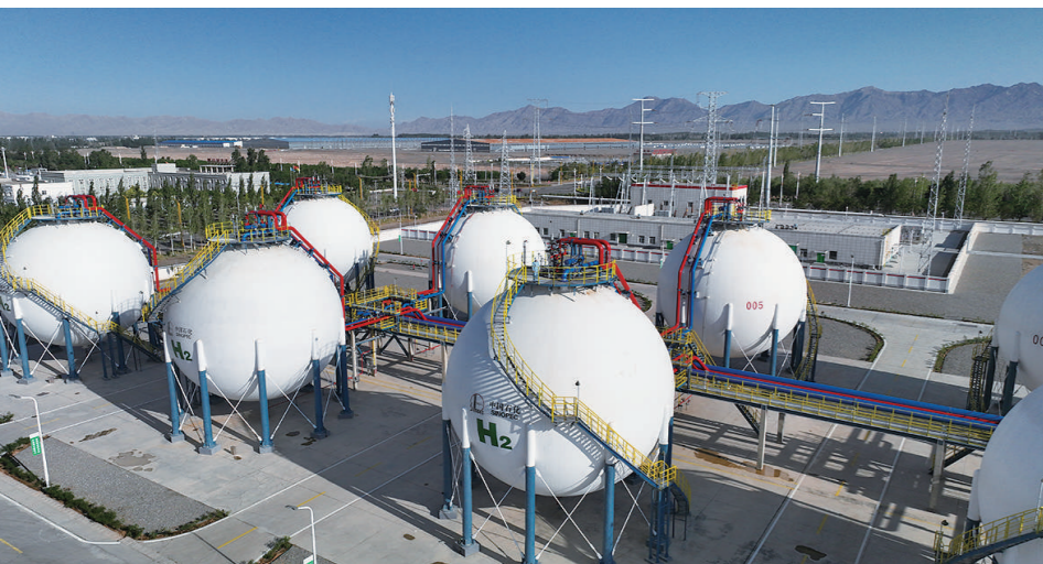
这是2023年6月30日拍摄的中国石化新疆库车绿氢示范项目制氢厂储氢罐区(无人机照片)。
