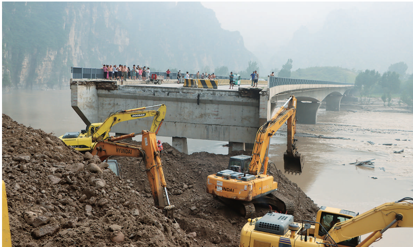
北京市房山区涑宝路四渡桥路基被洪水冲毁,桥面坍塌,中部战区陆军第82集团军某旅官兵抵达时,地方施工队伍在回填路基(8月3日摄)。
