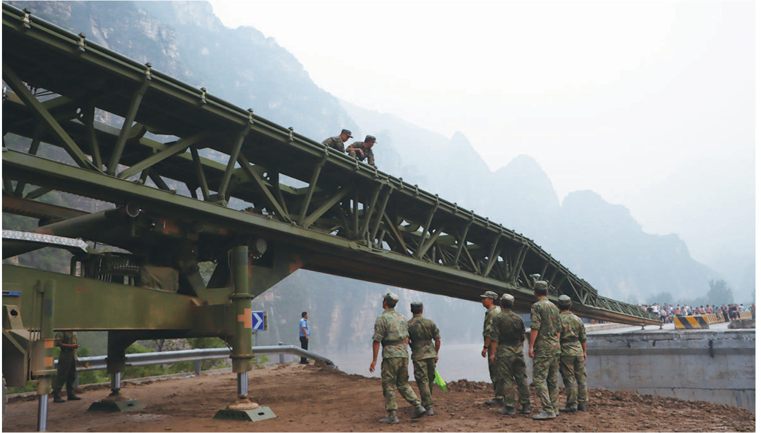
8月3日,中部战区陆军第82集团军某旅在北京市房山区涑宝路四渡桥断桥处架设桥梁,官兵们在推送桥体。
