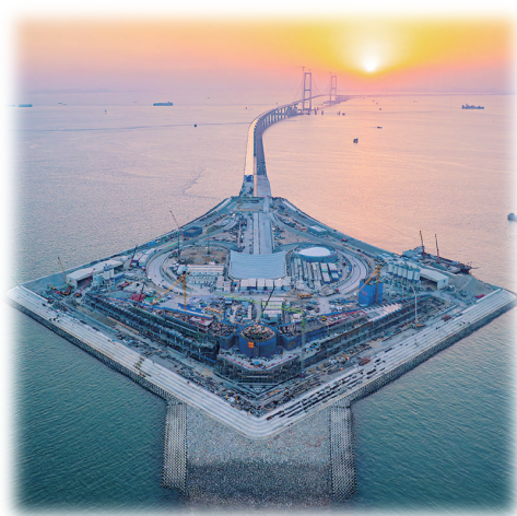
伶仃洋上的深中通道西人工岛,是实现跨海桥梁和海底隧道转换的关键。
