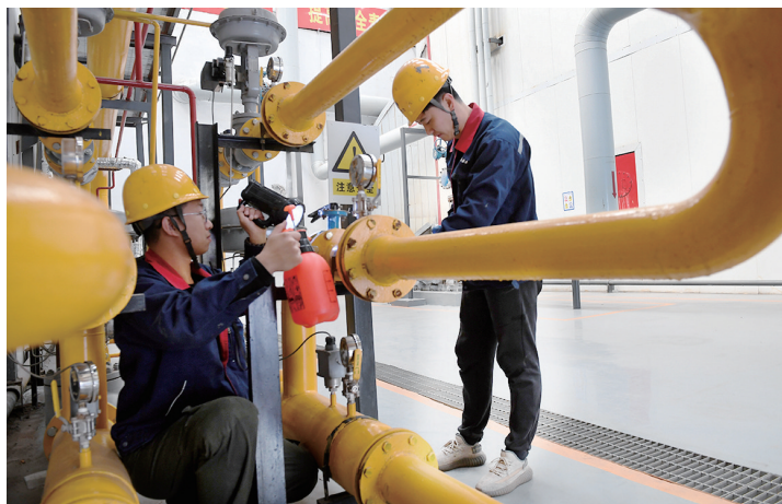
春节期间,市热力集团员工坚守岗位保供热。图为2月16日,热源分公司工作人员巡查设备。牛利敏 摄
