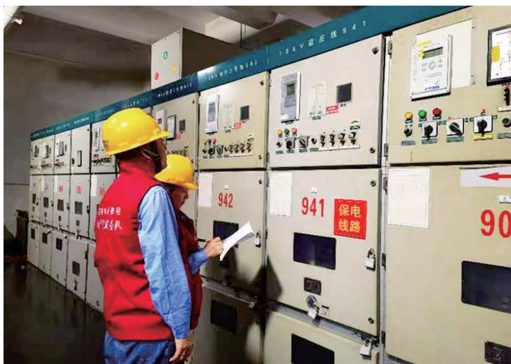
变电运维人员正在进行高考保电特巡。
