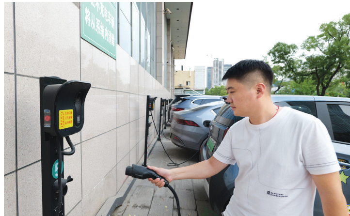
锦泽苑小区共享充电桩,让住户在家门口就能充电。
