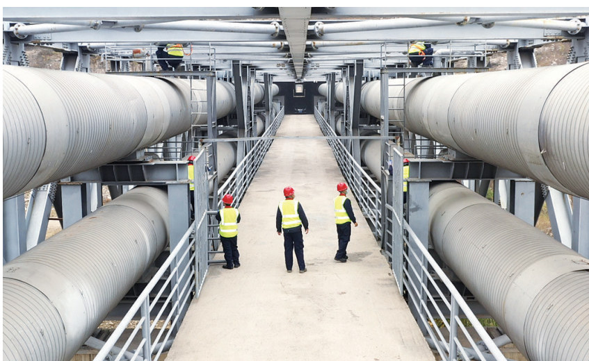
太原热力集团工作人员对太古高温网进行巡检。
