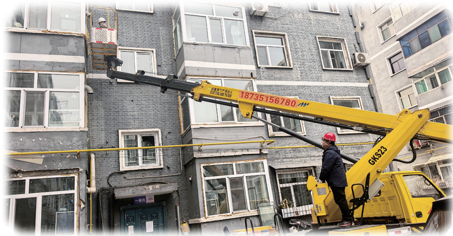
家中管道漏水,加上天气寒冷,导致七府坟南街苗圃小区4号楼一住户阳台外形成冰凌外挂,锋利尖锐。网格员在日常巡查中发现后,随即联动物业调用专业工程车紧急清除,及时化解悬在居民头顶的隐患。韩睿 摄
